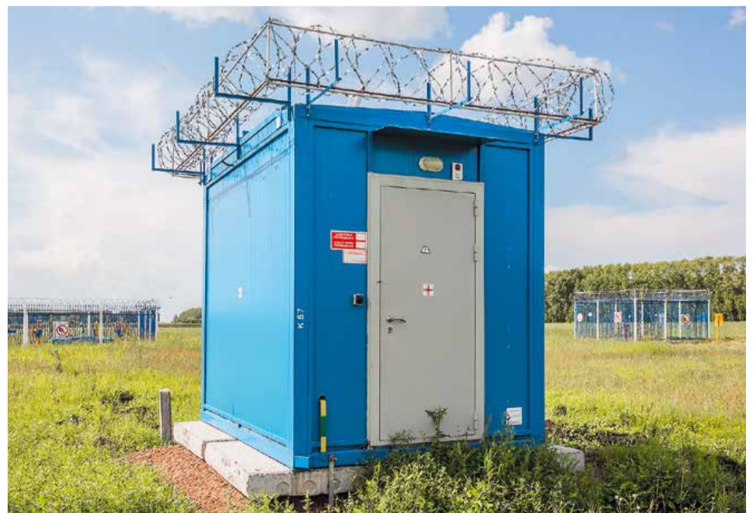
Энергонезависимый контролируемый пункт телемеханики в работе
